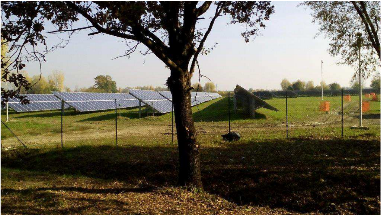
Foto 1. Impianto fotovoltaico di Castelfranco Emilia realizzato da Geovest per conto degli 11 Comuni
