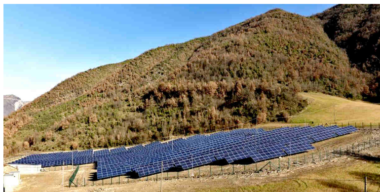
Cantiano: parco fotovoltaico "Casa dei Tosi" in Loc. San Rocco
