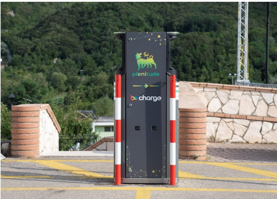
Fig. 9 (Colonnina elettrica per auto)
