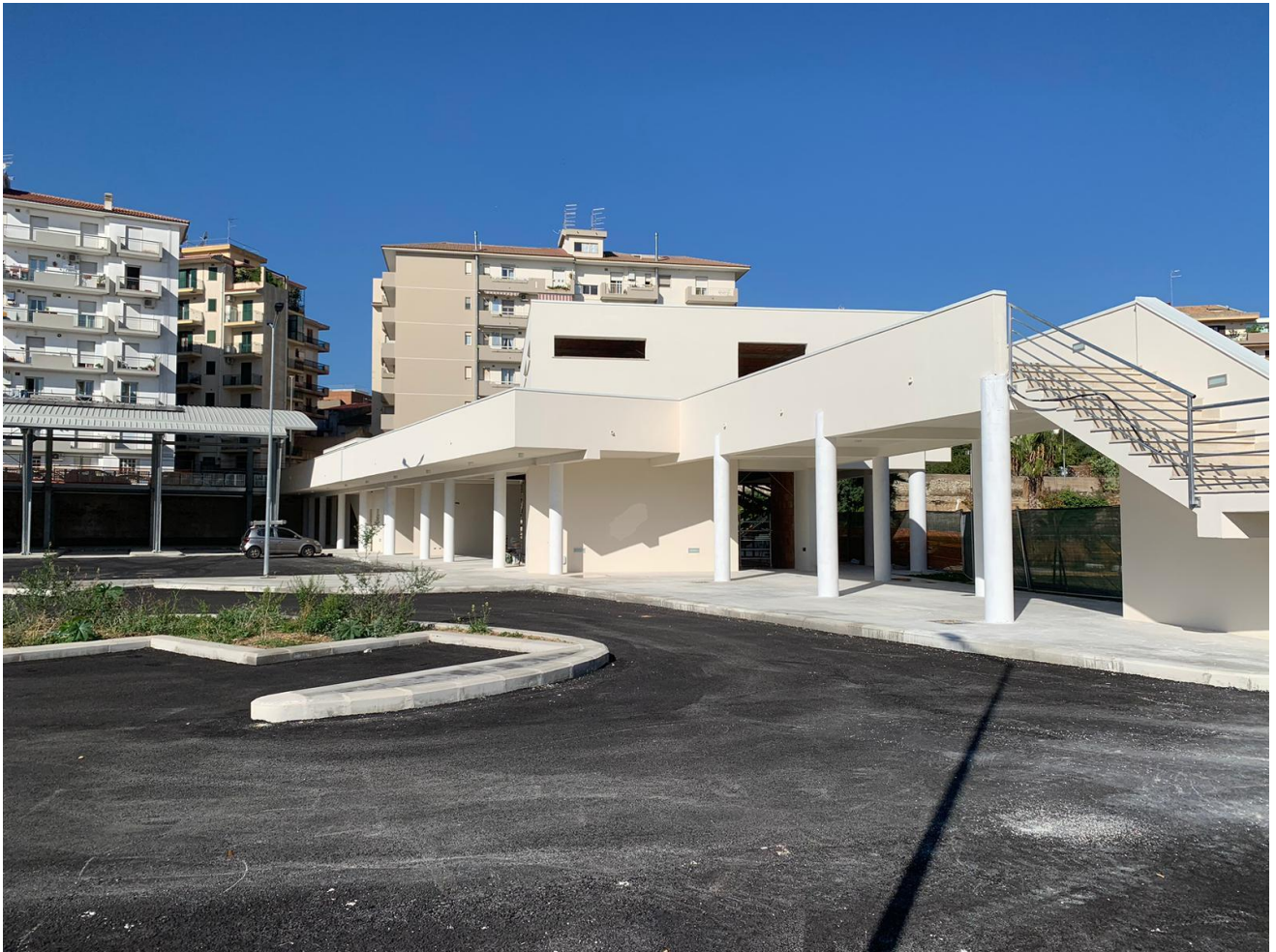
Foto dell'immobile destinato a ristorante, bar, edicola e servizi – in fase di realizzazione
