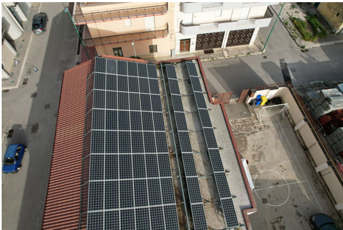
Impianto fotovoltaico in Poggiorsini.
